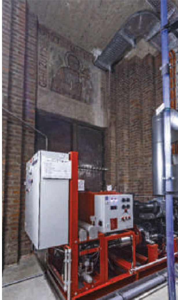
Neueste Technik in alten Kirchenmauern. Das Archiv des Bistums wurde in die Kirche St. Joseph integriert – ohne ihr Schaden zuzufügen.
