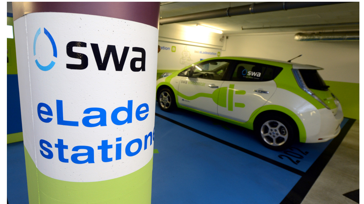
Eine E-Ladestation der Stadtwerke Augsburg Energie GmbH
