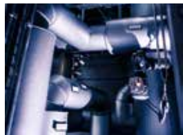
Lechhausen 14 Zukunftsweisende Energiespeicherung Power-to-Heat
